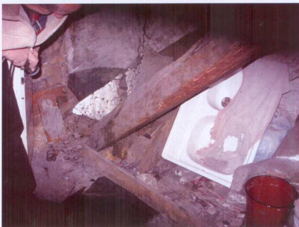
Fot. 10. Uszkodzona krokiew – wymagane zamocowanie końcówki krokwi oraz impregnacja
