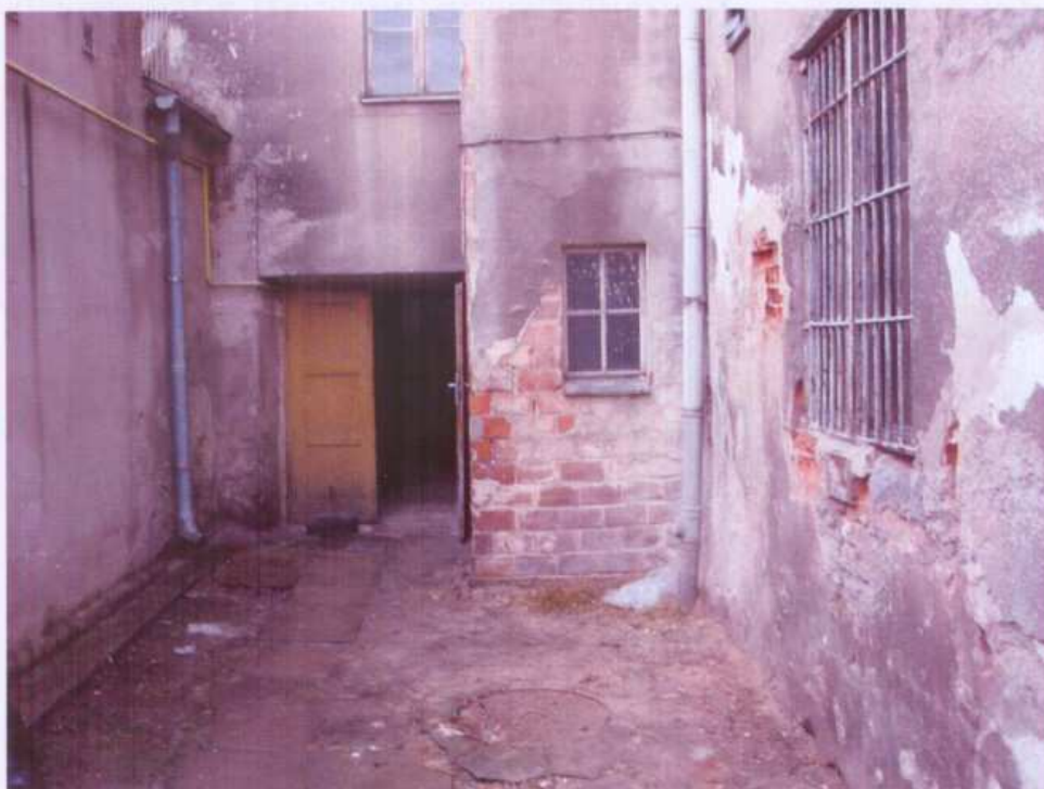
Fot.9. Podwórze przy budynku – widoczne uszkodzenia muru w wyniku zawilgocenia
