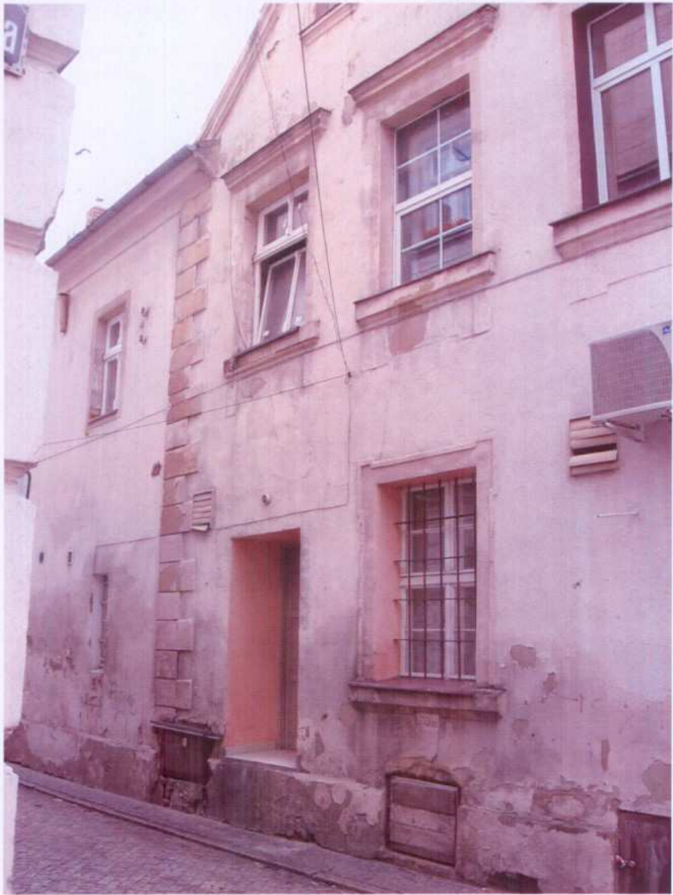
Fot.11.Zawilgocenie ściany północnej budynku głównego
