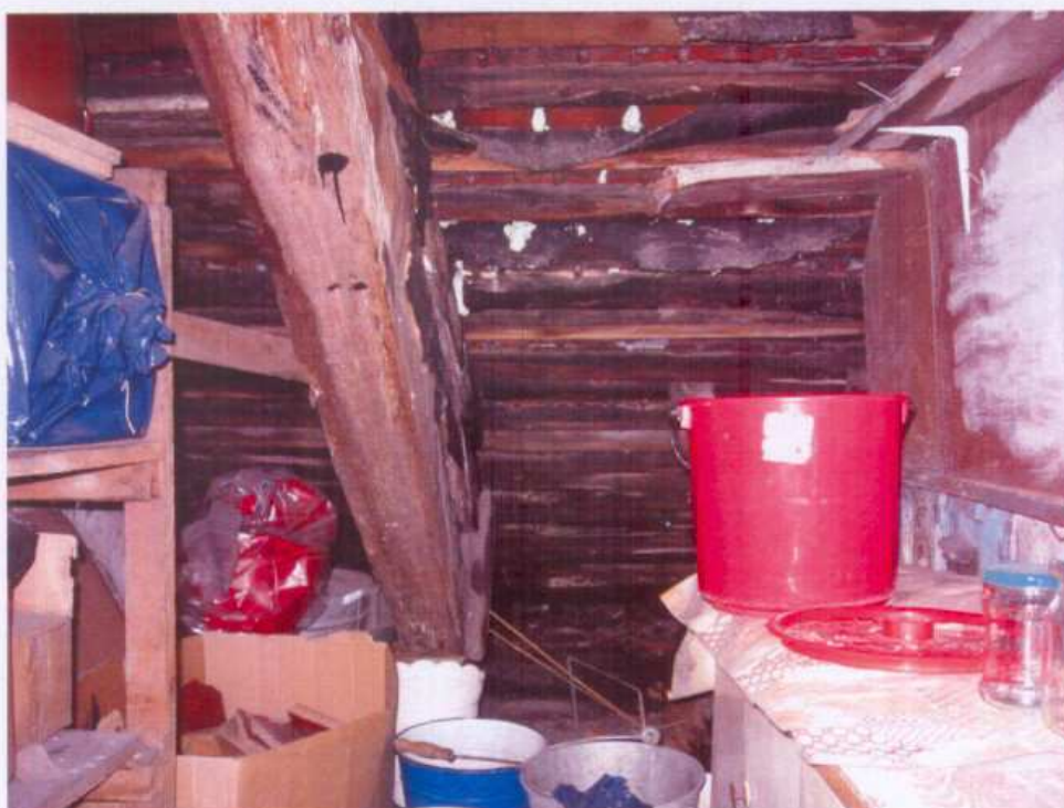
Fot. 12. Zacieki dachu budynku głównego (komórka lokatorska od strony podwórza)
